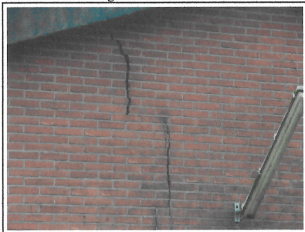
Foto 15: scheuren gevel kleine stal
