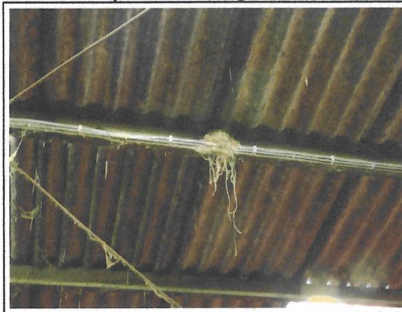
Foto 16: nest op dakconstructie grote stal
