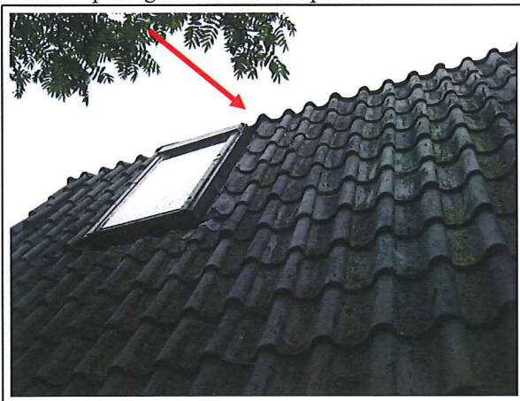
Foto 9: openingen tussen de dakpannen
