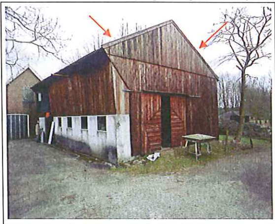
Foto 17: asbesthoudende golfplaten gebouw E (item 2)
