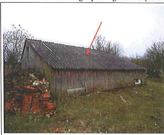
Foto 24: asbesthoudende golfplaten gebouw J (item 6)
