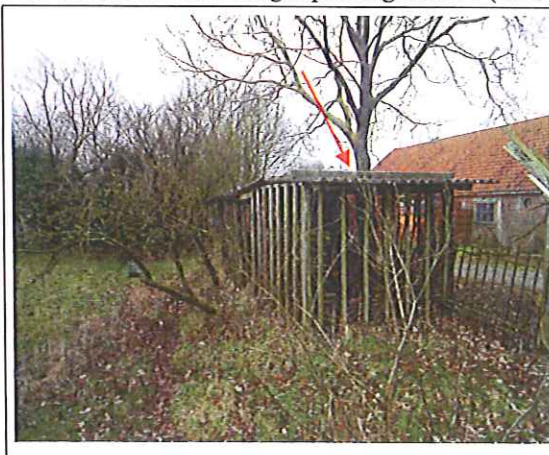
Foto 23: asbesthoudende golfplaten gebouw I (item 5)
