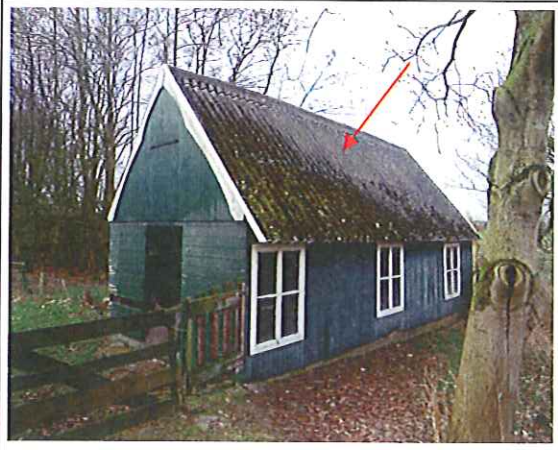
Foto 19: asbesthoudende golfplaten gebouw F (item 3)
