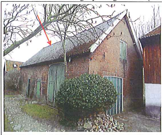
Foto 15: asbesthoudende golfplaten gebouw D (item 1)
