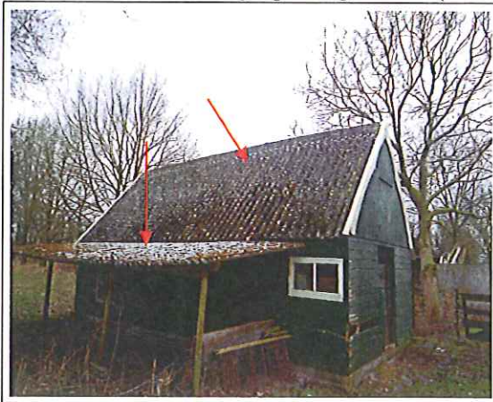
Foto 20: asbesthoudende golfplaten gebouw F (item 3)
