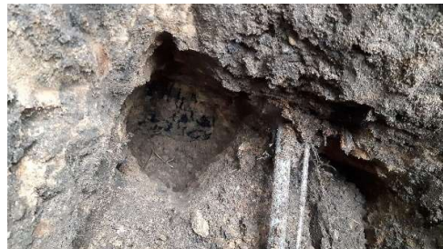
bovenkant tank en leiding
