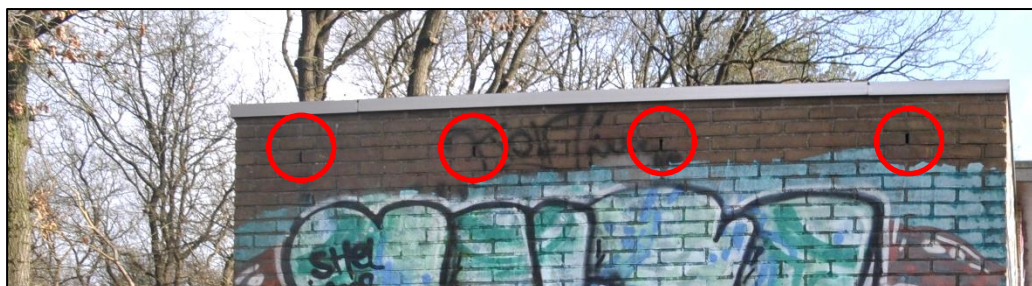
Figuur 7. De open stootvoegen in de muur van het onderstation.
