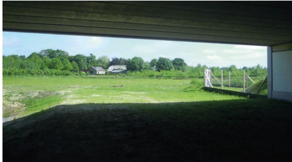
Faunapassage Hoge Woerd, zicht naar het noorden
