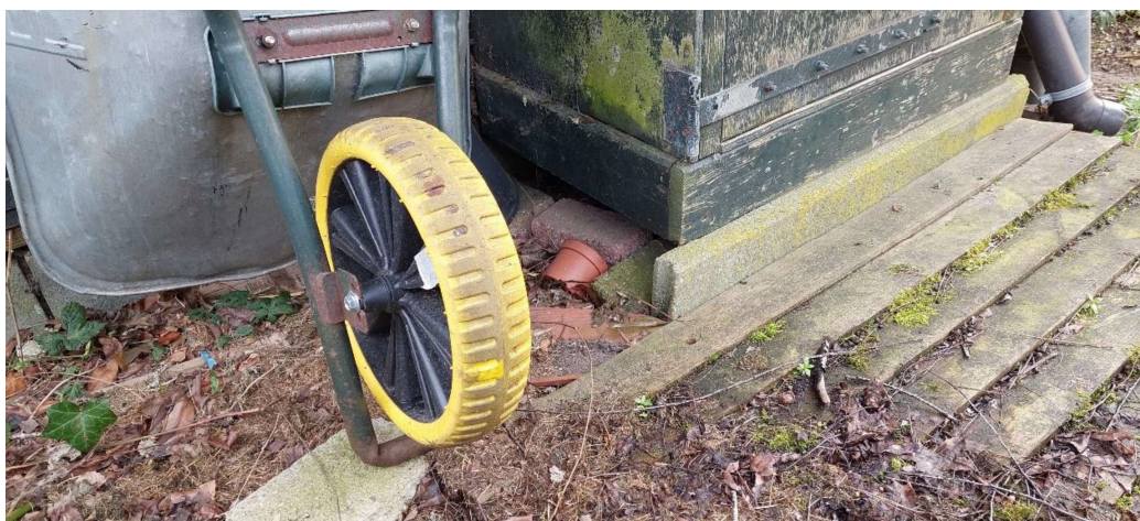
Onder schuur 2 is ruimte aanwezig. Foto: [REDACTED] Ecoresult BV
