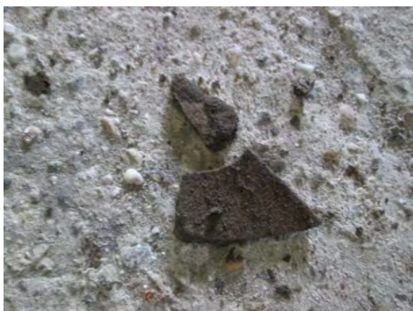
Foto 9: Aangetroffen 2 stukjes asbestverdacht materiaal in gat 7
