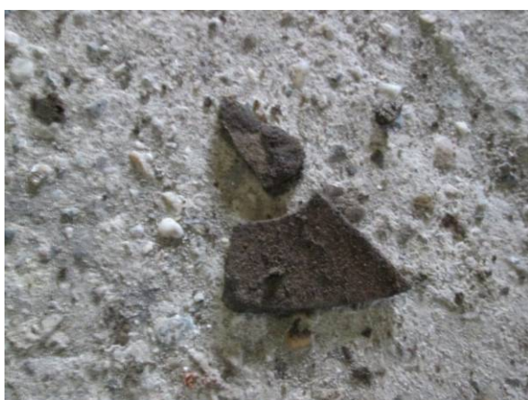
Foto 9: Aangetroffen 2 stukjes asbestverdacht materiaal in gat 7
