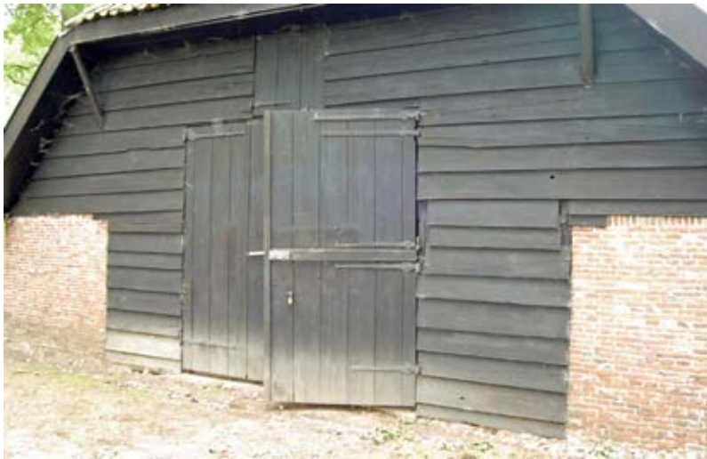
Afb. 3.4. Noord-oostgevel met rechts van de dubbele deuren een dichtgezette loopdeur waarvan één duimheng aan de rechter zijde bewaard bleef.
