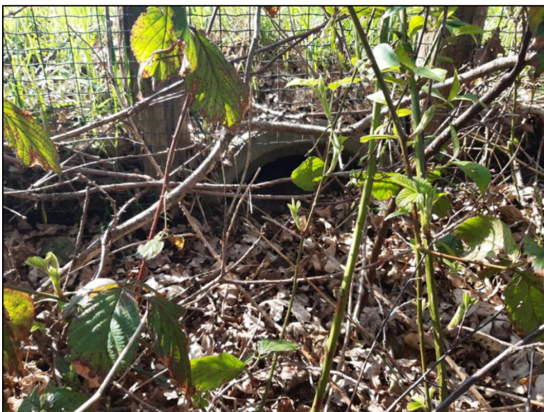
Figuur 7: Noordelijke ingang van de dassentunnel die onder de Dwarsweg doorloopt. Deze ingang is geblokkeerd door opgehoopt zand en bladmateriaal en lijkt niet in gebruik te zijn door dassen.
