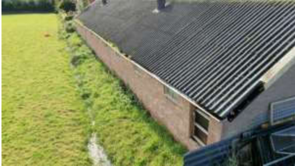
Figuur 16: Asbestverdachte golfplaten oostzijde
