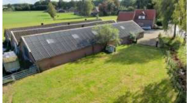
Figuur 17: Asbestverdachte golfplaten westzijde
