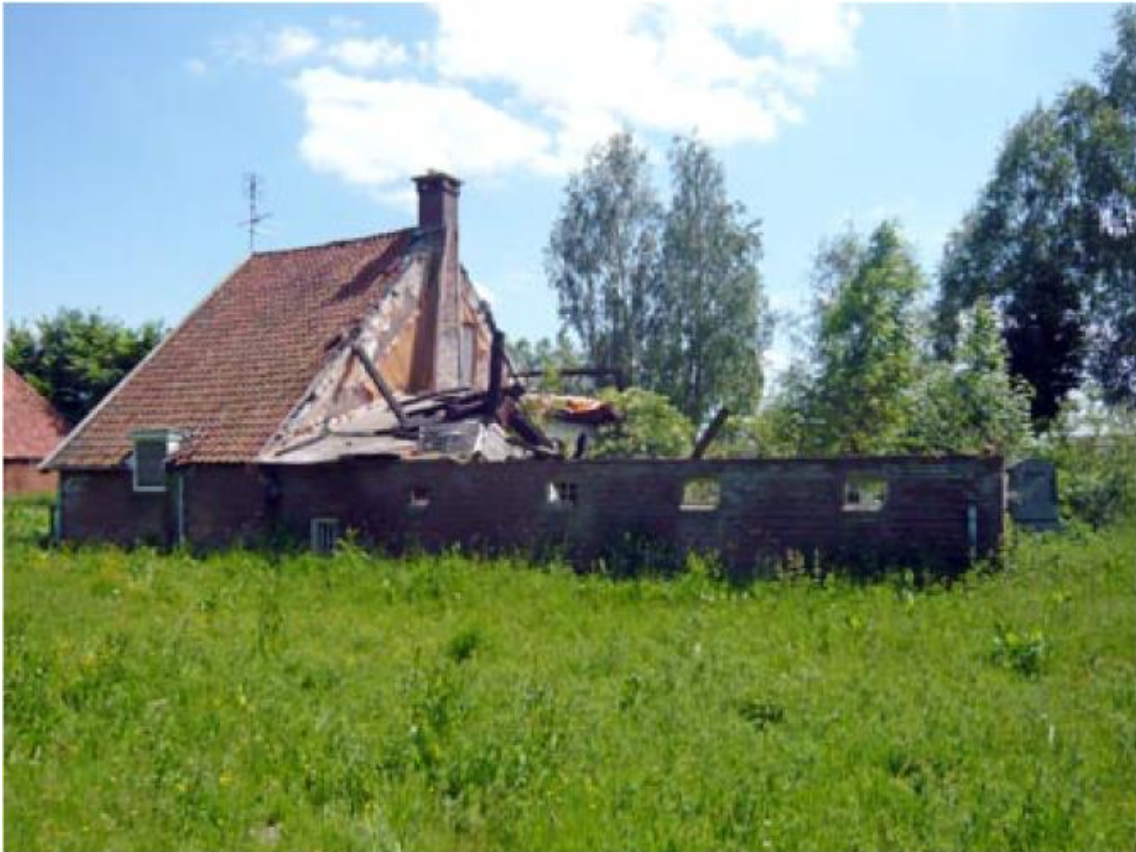
Afbeelding 5: De boerderij en de gevolgen van de brand gezien vanuit het westen (bron: Bouwhistorische opname met waardestelling voormalige ridderhofstad Wayenstein, BBA)
