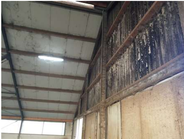
Detailopname van de zijgevel van de schuur waar tegenaan de voerruimte wordt gebouwd. Deze wand vormt een ongeschikte nestplaats voor vogels.
