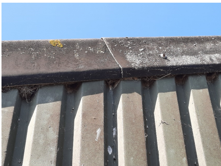
Figuur 5.1: Nesten huismus aangetroffen tussen damwandplaat en windveer van de stal
