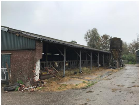
Koeienstal met asbestdak
