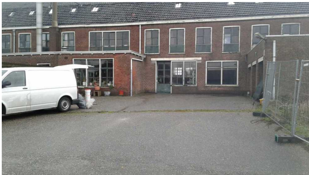
Foto 2: gedeelte asfaltverharding, halverwege is een van de opgebroken stroken waar te nemen.
