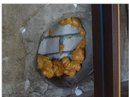
Foto 45: Geen openingen bij gevels/kozijnen.
