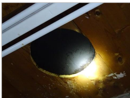
Foto 36: Geen openingen bij dakrand/zoldering.
