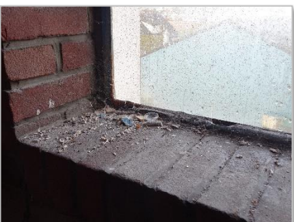
Foto 47: Geen openingen bij gevels/kozijnen.
