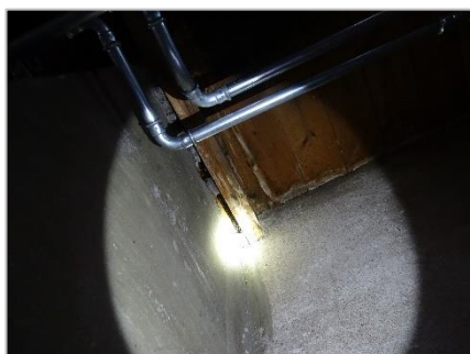
Foto 35: Geen openingen bij dakrand/zoldering.
