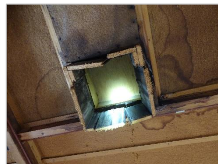
Foto 43: Geen openingen bij dakrand/zoldering.
