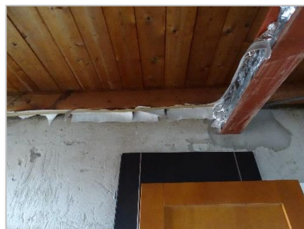
Foto 42: Geen openingen bij dakrand/zoldering.
