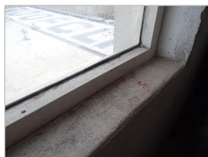
Foto 46: Geen openingen bij gevels/kozijnen.
