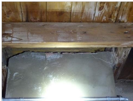
Foto 39: Geen openingen bij dakrand/zoldering.
