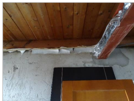
Foto 42: Geen openingen bij dakrand/zoldering.
