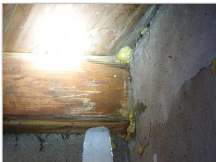
Foto 38: Geen openingen bij dakrand/zoldering.
