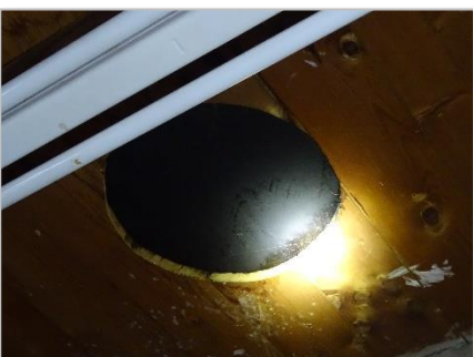
Foto 36: Geen openingen bij dakrand/zoldering.
