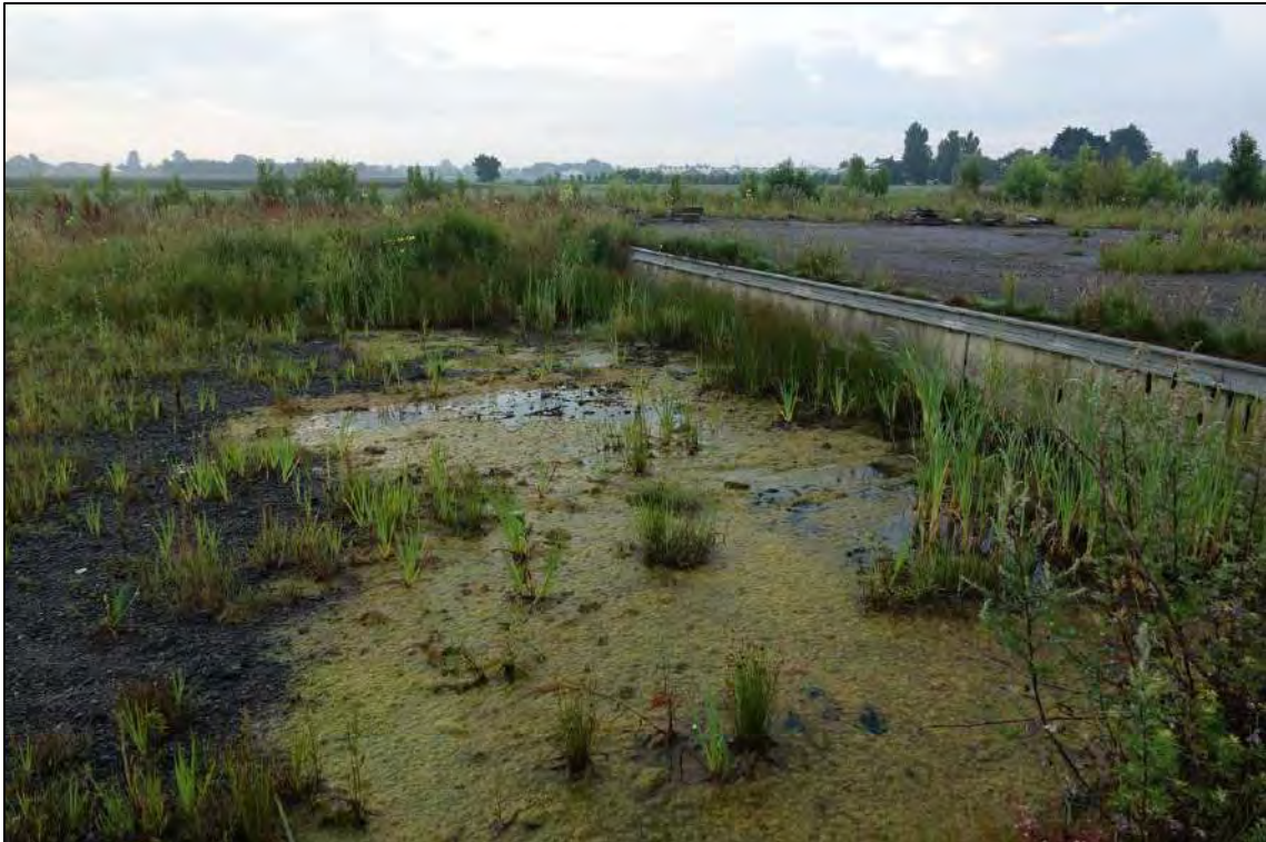
Figuur 8: Het talud op de achterzijde van het terrein waar ondiep water in blijft staan.
