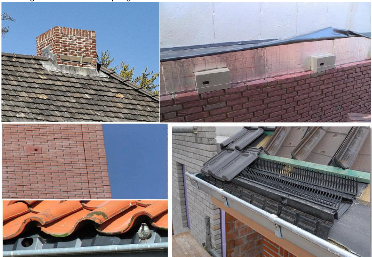
Boven: ingebouwde vleermuisstenen in schoorsteen. Gierzwaluwstenen in gevel. Onder: mussenvides.
