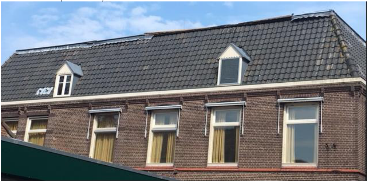
Situatie na storm (foto ODWH)
