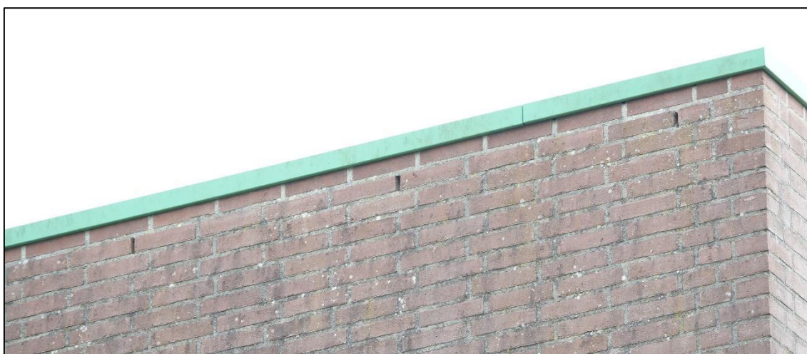
Figuur 8: Open stootvoegen onder de dakrand rondom het gebouw waar de gevel uit baksteen bestaat.
