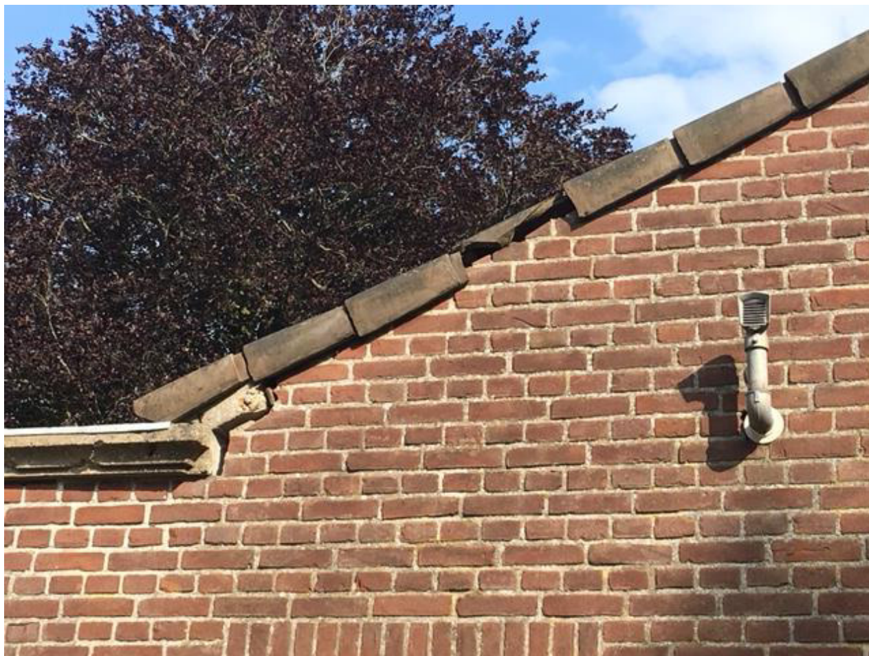
Scheur en kapotte pan bij het ketelhuis. Deze bevinden zich op 2,4 en 2,8m hoogte onder een lamp.
