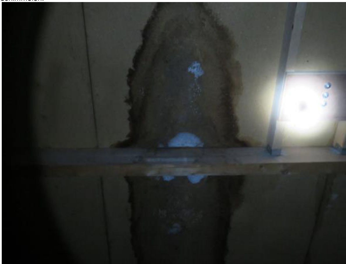
Foto van schimmel waar regenwater door verschoven dakpan op de zolder naar binnen komt.
