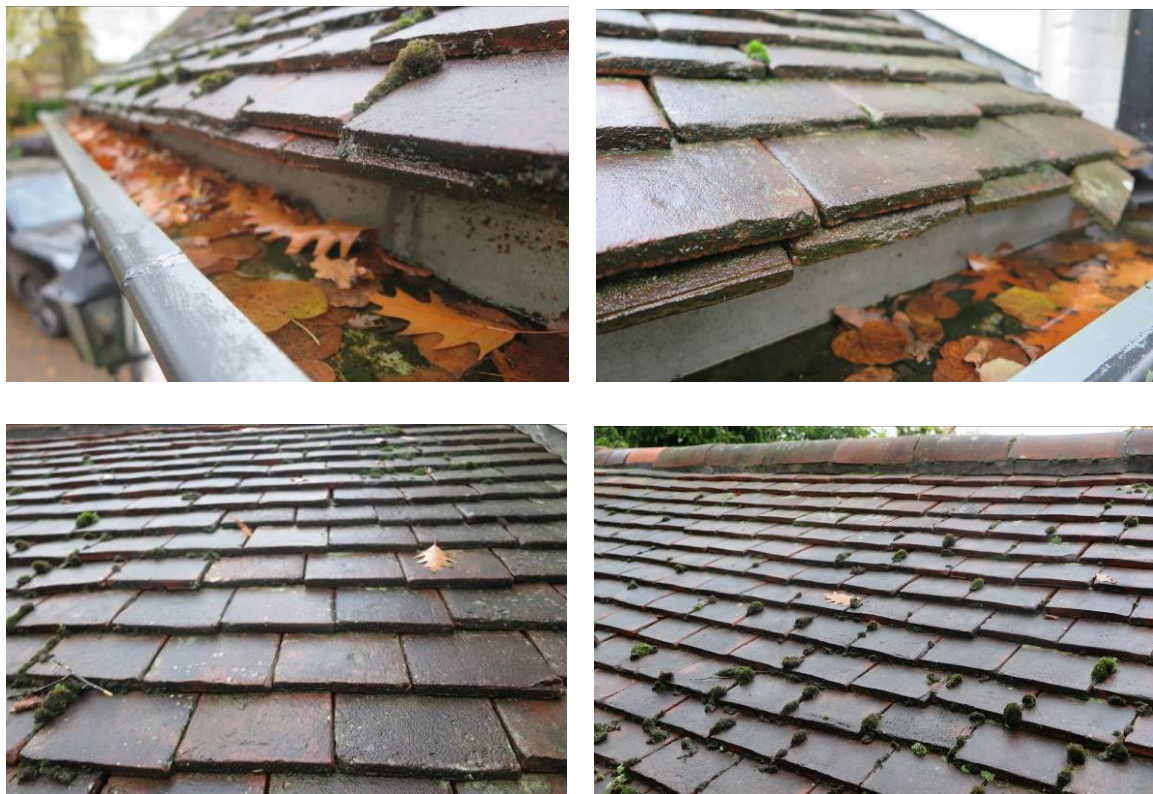
Figuur 5. Ongeschikt dak voor huismus en gierzwaluw doordat geschikte openingen ontbreken.
