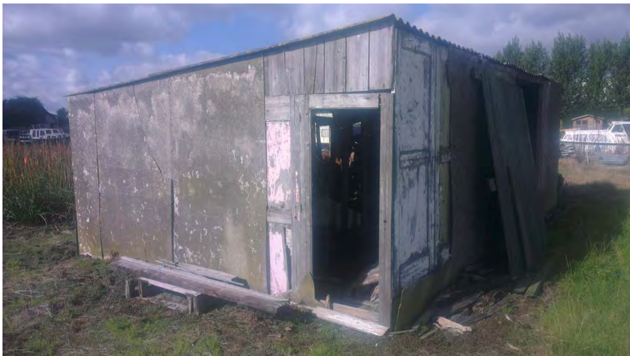
Foto 1. Schuurtje met asbestverdachte (golf)platen
