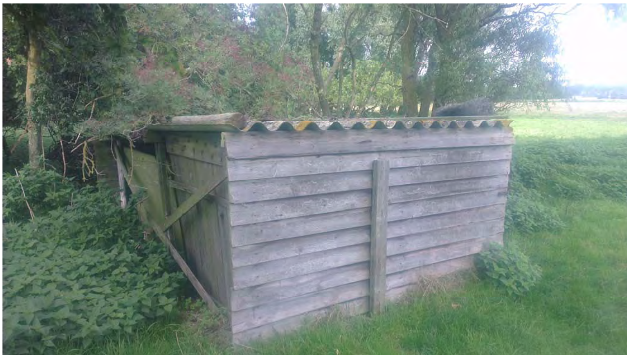
Foto 4. Schuurtje met asbestverdachte golfplaten
