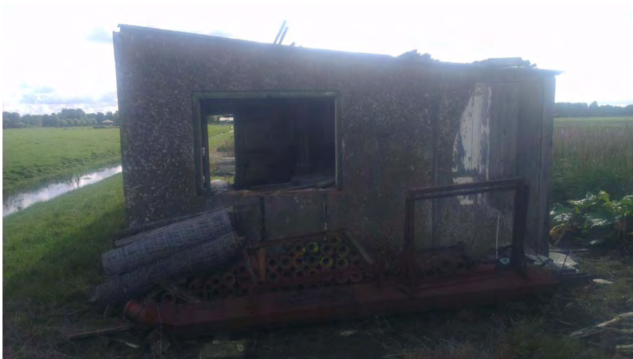
Foto 2. Schuurtje met asbestverdachte (golf)platen
