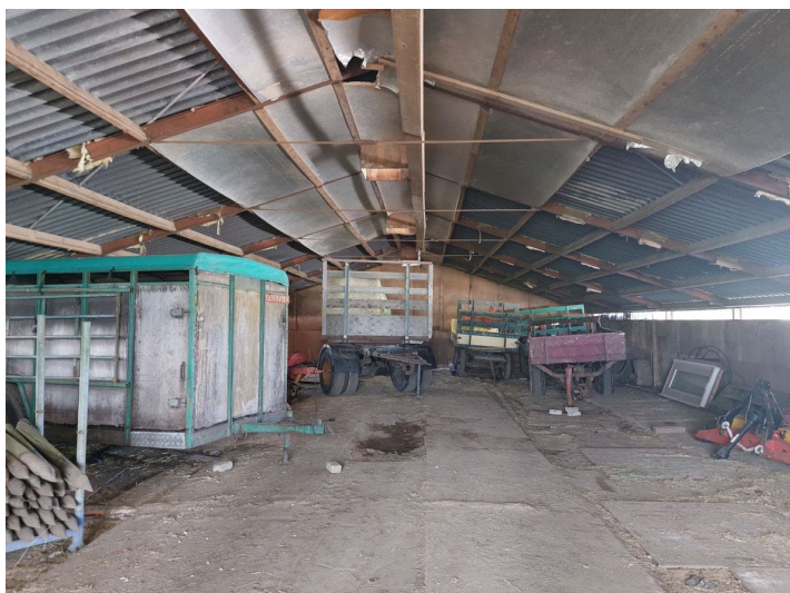
Figuur 5.2: Deels vervallen plafondplaten in de loods
