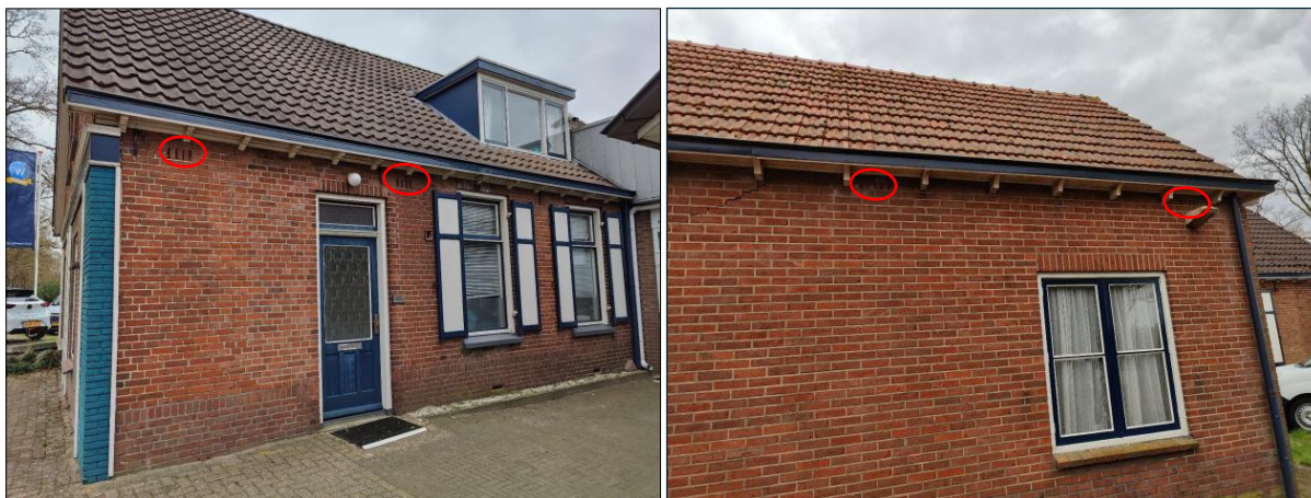
Gaten in metselwerk, in rood omcirkeld.
