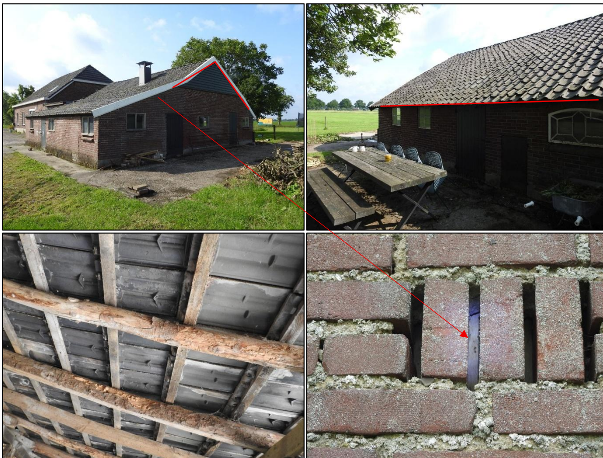
Figuur 11. Gebouw 2. Linksboven een aanzicht vanaf de noordzijde. De rode lijn geeft ruimte onder de daklijst waar vleermuizen tussen kunnen kruipen. Rechtsboven: de westgevel waar vleermuizen onder het dak door in de spouw kunnen kruipen. Rechtsonder: stootvoegen in de gevel, deze komen rechtstreeks aan in de schuur zelf (er is hier geen spouwmuur). Van binnen is dit dichtgemaakt met een houten plank, de stootvoeg zelf is echter nog wel toegankelijk. Linksonder: de pannen liggen op een houten raamwerk, er is geen dakbeschot en dus geen mogelijkheden voor huismus of vleermuizen om onder het dak te verblijven. Foto's: De Interim Ecoloog.
