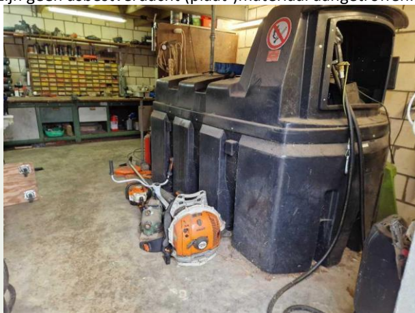
Figuur 10: Bovengrondse dieseltank
