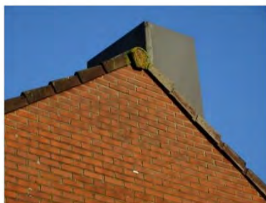
Figuur 2.4 Overhangende kantpannen aan de kopgevel.
