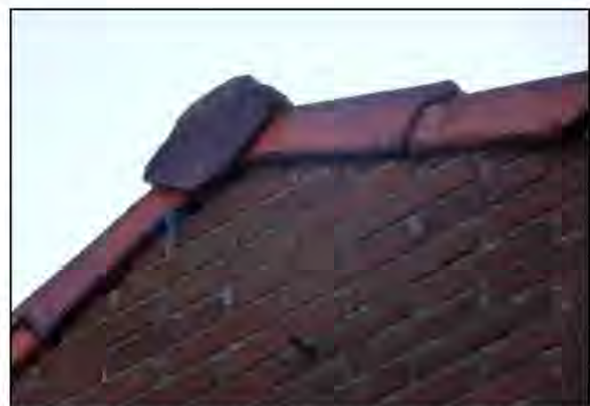
Figuur 11. Overhangende kantpannen en nokvorst met een ruime opening.
