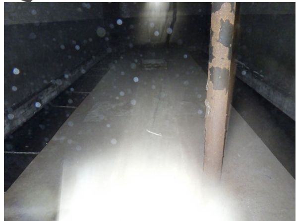
Dekvloer met ingeschaald asbest
