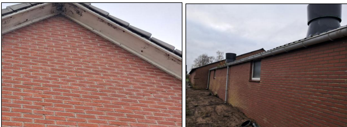
Foto 3 links: deel van de dak overstek van een van de schuren. Foto 4 rechts: deel van de gevel van een van de varkensstallen.
