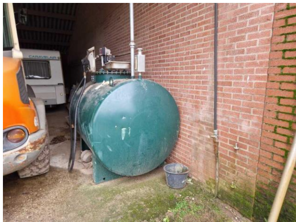
Figuur 9: Bovengrondse dieseltank
