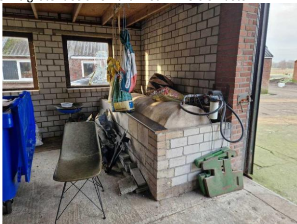
Figuur 9: Bovengrondse dieseltank
