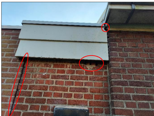
Gaten in metselwerk, in rood omcirkeld.
