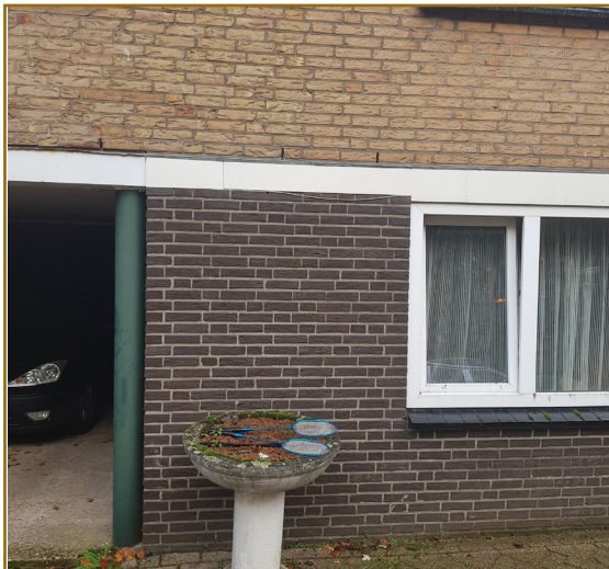
Afbeelding 2.9: Open stootvoegen aan de zuidelijke kant van het middelste, smallere deel van de bebouwing.
