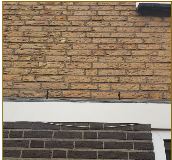
Afbeelding 2.10: Open stootvoegen aan de zuidelijke kant van het middelste, smallere deel van de bebouwing.
