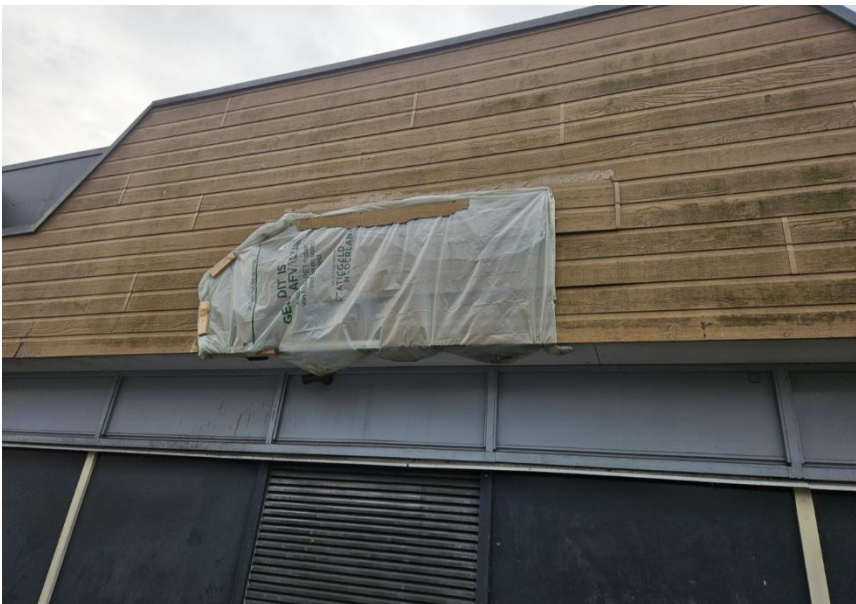
Figuur 8: Kapotte gevelbeplating aan de noordgevel van de bebouwing
