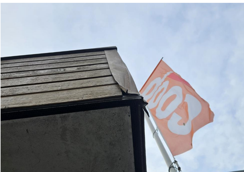
Figuur 9: Kapotte gevel in het noorden van het plangebied
