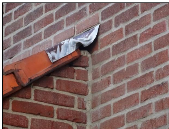
Figuur 13. Openingen onder het lood langs een dakrand.
