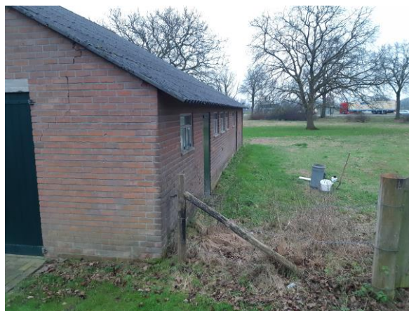
Foto 4: Schuur op de locatie met asbestverdachte dakbedekking zonder dakgoot.
