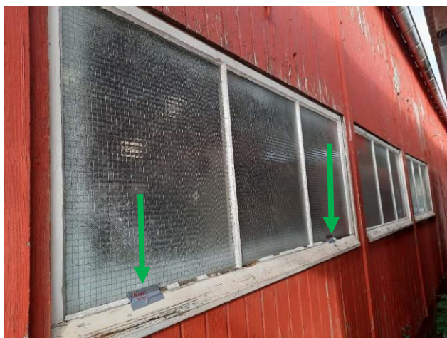
Situering MM03, stopverf glas achtergevel gebouw 2
