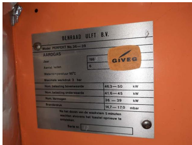
CV- ketels Benraad 1983, ketelruimte 1e verdieping gebouw 1, niet asbesthoudend conform "Kleintje Asbest"
