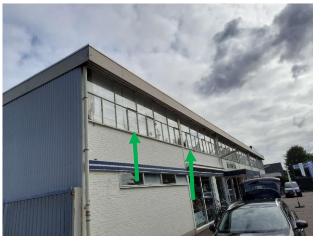
Situering MM06, stopverf stalen raampartijen voor- en rechtergevel gebouw 1
