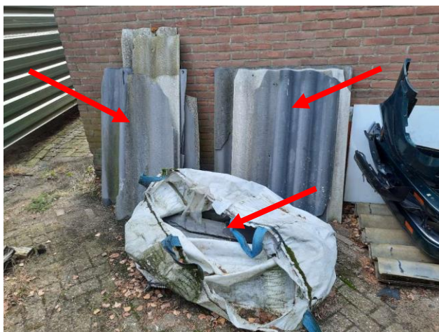
Ref.MM04, losse delen golfplaat zijgevel gebouw 3
