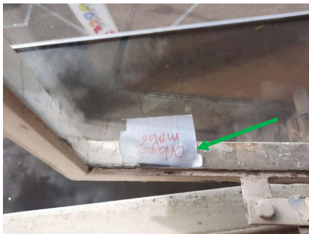
MM06, stopverf stalen raampartijen voor- en rechtergevel gebouw 1
