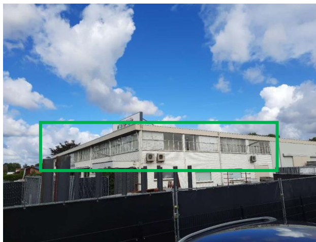
Overzicht stopverf stalen raampartijen voor- en rechtergevel gebouw 1
