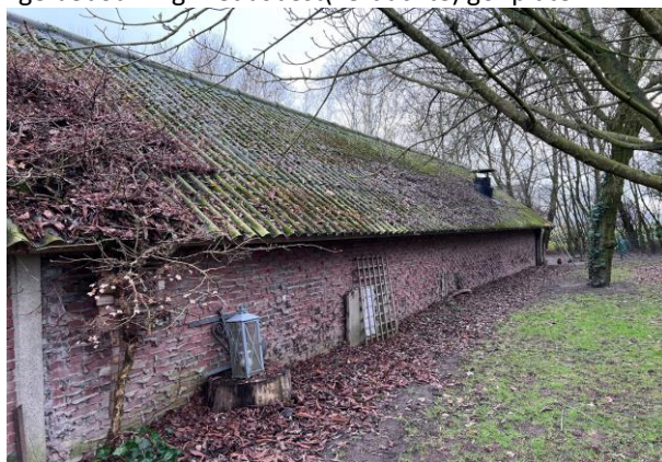
Figuur 14: Asbestverdacht dak met druppelzone
