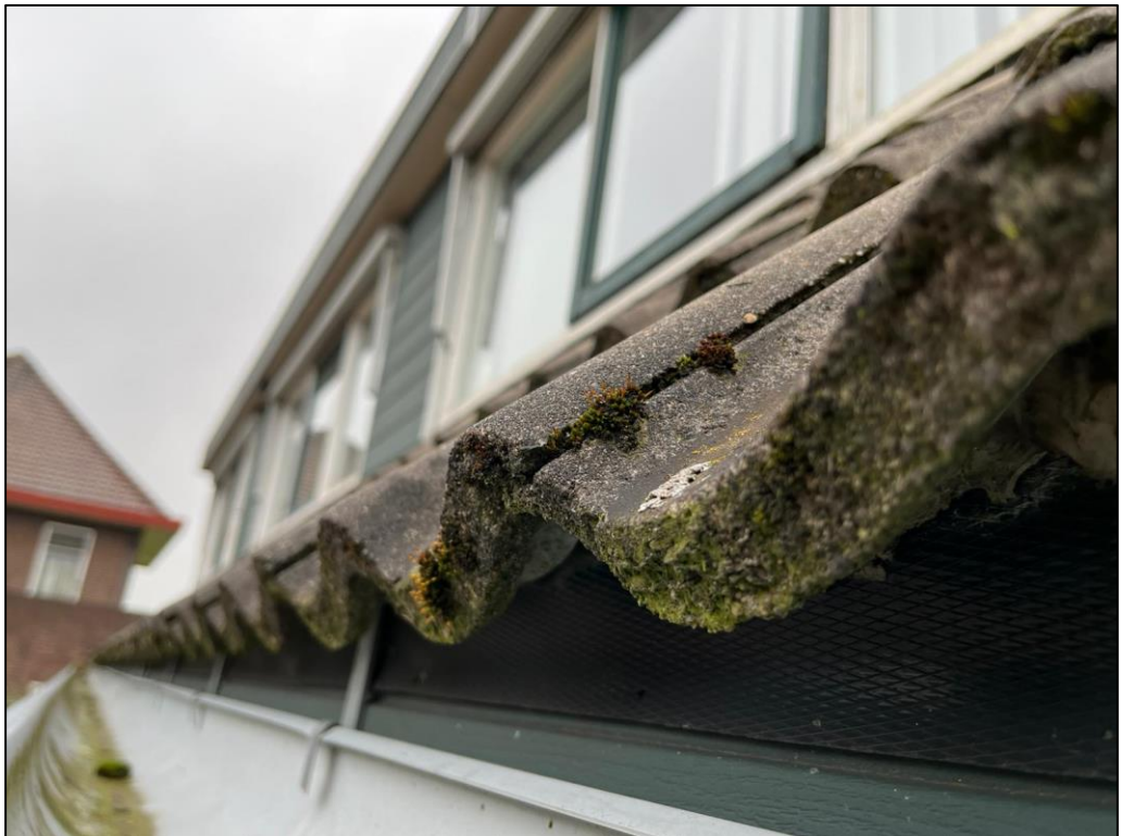
Dezelfde dakpannen, waarop te zien is dat er geen ruimte aanwezig is onder de pannen.
