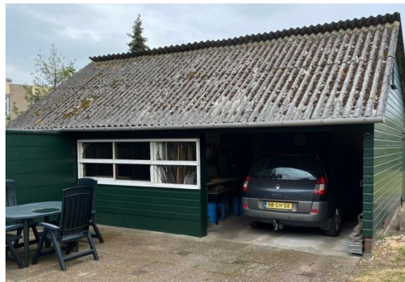
Foto 2: zuidzijde schuur, dakgoot en regenpijp
