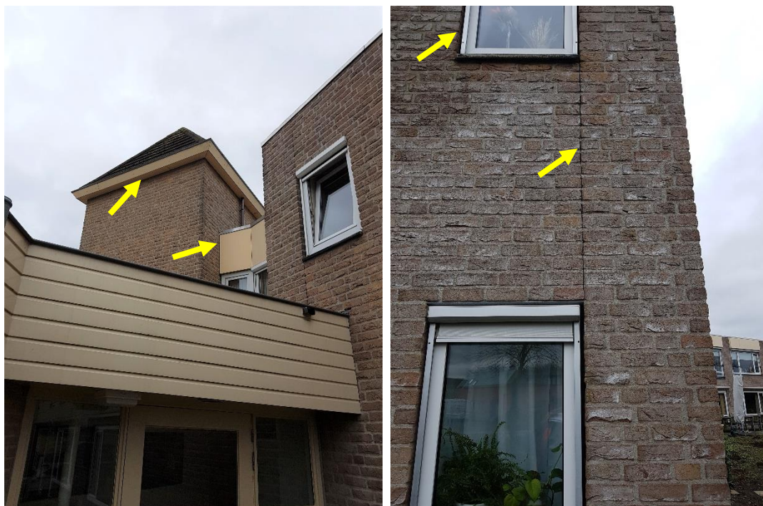
Figuur 6: Openingen langs randen van het torentje in het centrale deel van het grote gebouw (links) en openingen langs raamkozijnen en een dilatatievoeg (rechts).
