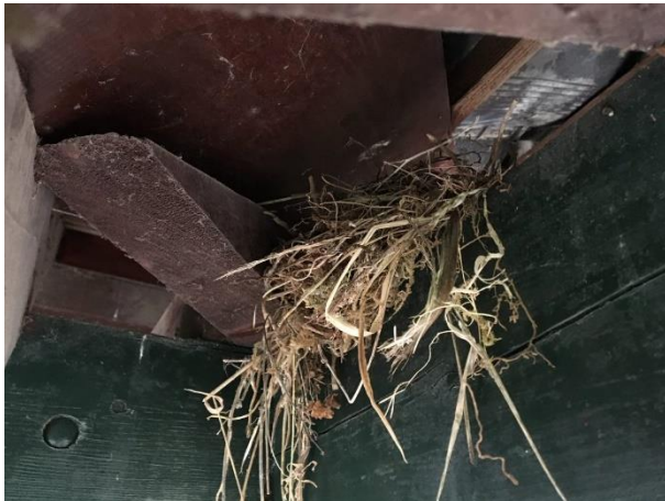
Oud merel nest onder het dakvlak van de carport
