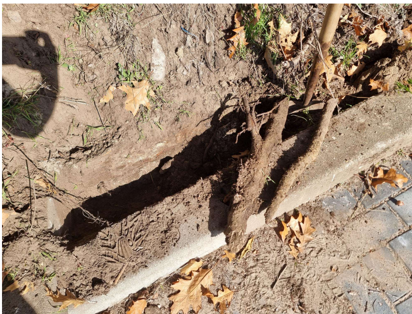
Afb 1: Aangetroffen wortelresten bij herstelwerkzaamheden asfalt
