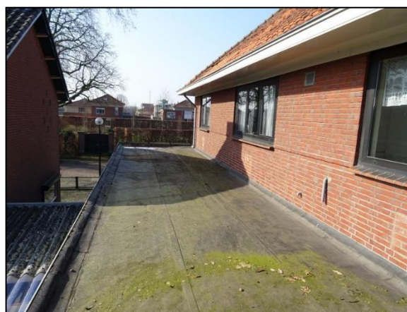
Figuur 11. Pannendak eindigt in dakgoot, gierzwaluwen kunnen hier niet invliegen.
