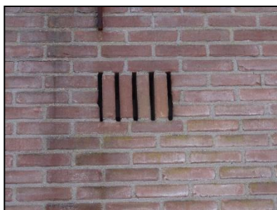
Figuur 14. Brede openingen bij de ventilatieschacht geven toegang tot de spouw.
