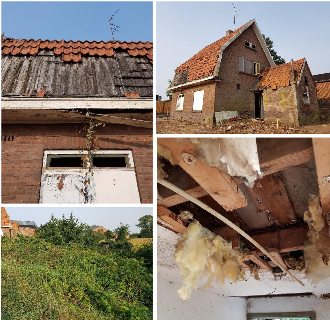
Figuur 2 (linksboven). Missende daktegels en een dichtgetimmerd raam aan de oostkant van het gebouw.
