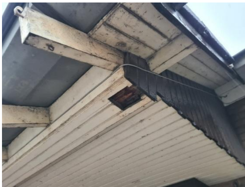
Ruimte tussen gevelbetimmering en dakbeschoot van bedrijfswoning
