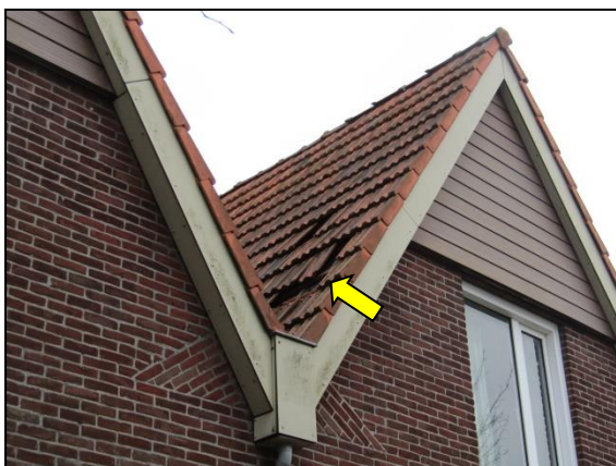
Figuur 16. Dakbedekking in slechte staat
