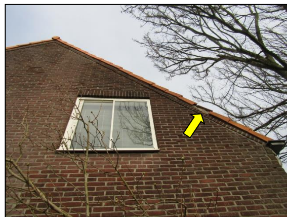
Figuur 17. Ontbrekende kantpan.
